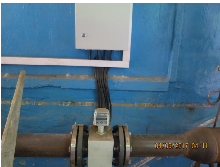
Установка счетчика горячей воды ЦТП-20
